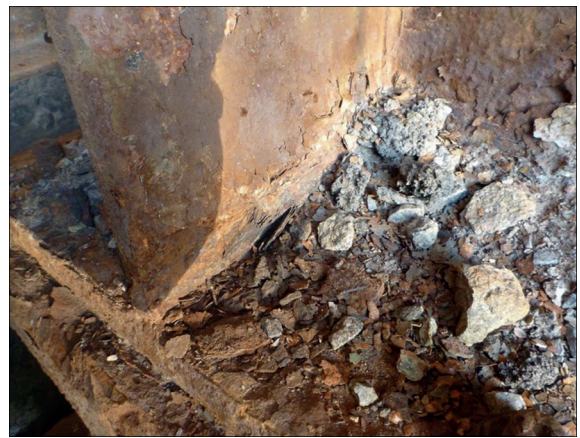
Рис. 10. Ділянка скупчення сміття в опорній частині чотирипрогонової споруди
