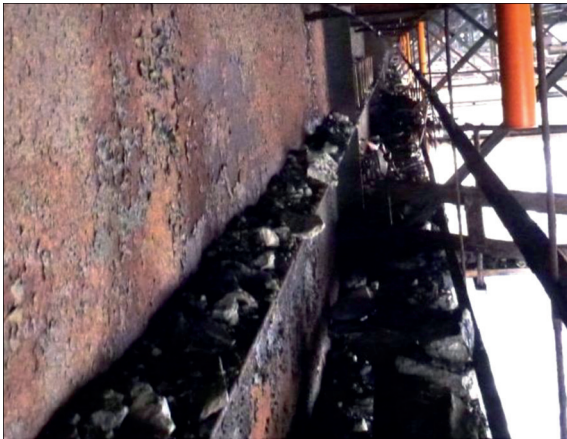
Рис. 8. Ділянка скупчення сміття та стану оглядових проходів з внутрішньої сторони крайньої балки п'ятипрогонової споруди
